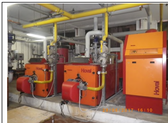
Caldaie con coibente in FAV nella centrale termica
