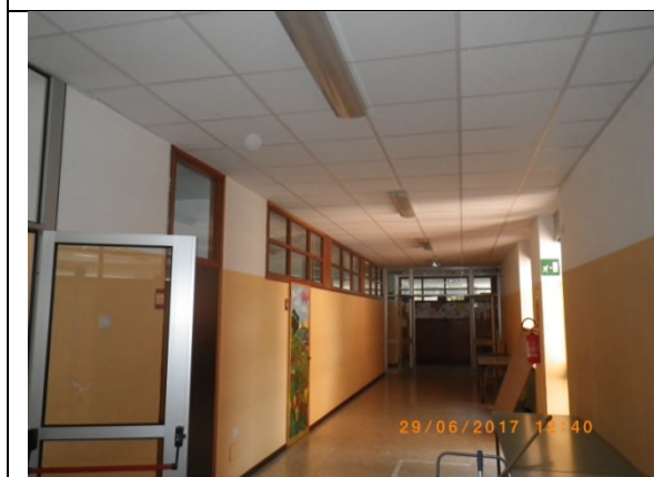
Pannelli in FAV dei controsoffitti nelle aule e nei corridoi
