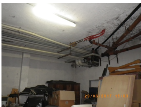
Tubazioni con coibente in FAV nelle cantine
